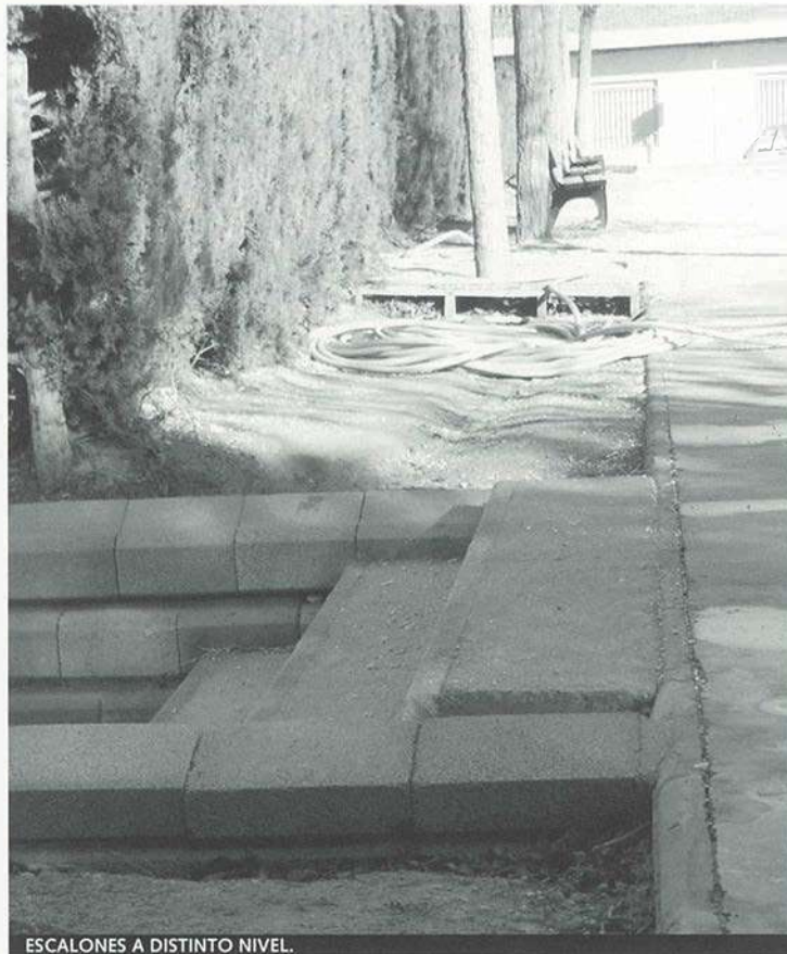
ESCALONES A DISTINTO NIVEL.
