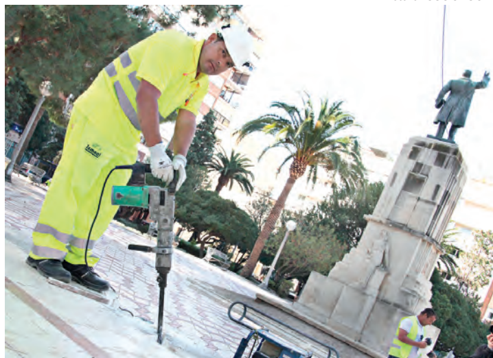
El pavimento está muy deteriorado por lo que será sustituido
